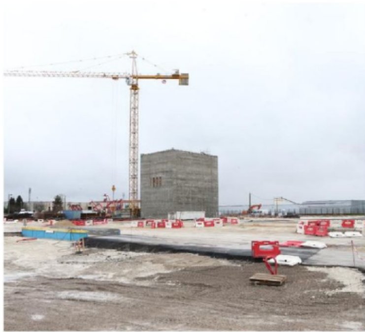
Sur la zone industrielle des Près-de-Lyon, les travaux de l'incinérateur vont bon train. Photo Ludovic PETIOT
