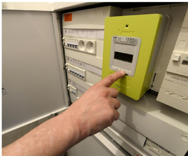
À Fontaine, 85 % des foyers sont équipés aujourd'hui du compteur électrique Linky. Illustration
